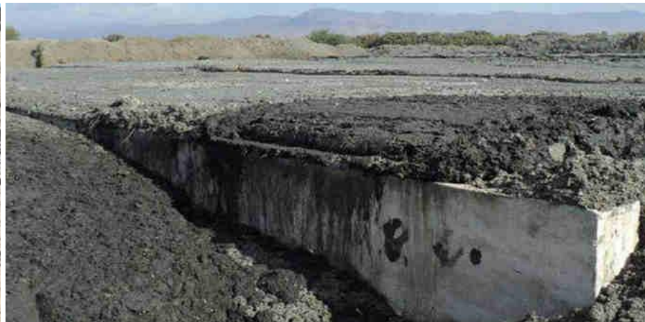
Photo n°4 : Casier de séchage des boues –STEP M'ZAR
